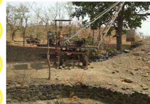
古井戸は重機を使って数メートル掘り下げると、再び地下水が湧き上がってきました!
