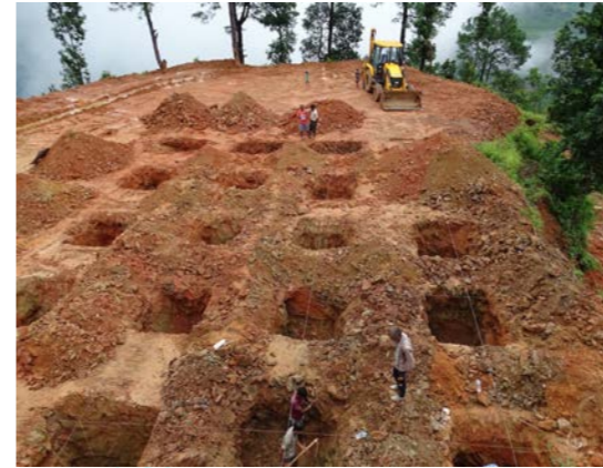
トレーニングセンターの建設が開始され、日本の耐震基準を満たす基礎工事を行いました。
